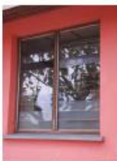
[ FIG. 2.55 ] Vidros basculantes: permitem a regulação do fluxo de ventilação.
