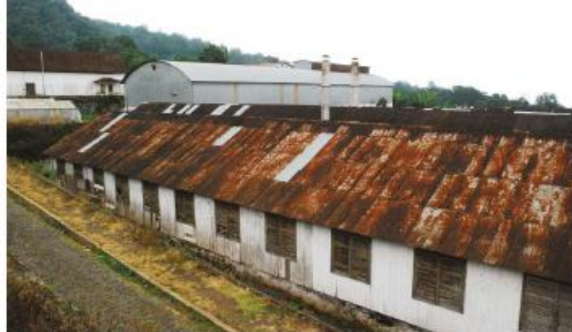
{ FIG. 2.29 } O uso sem protecção (isolamento) de material metálico para coberturas deve ser evitado, dado que leva ao agravamento de situações de sobreaquecimento interno – em particular quando a cobertura oxida (enferrujão) e perde a sua capacidade de reflectir parte de radiação solar.
